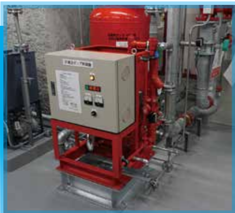
真空ポンプユニットの設置状況
